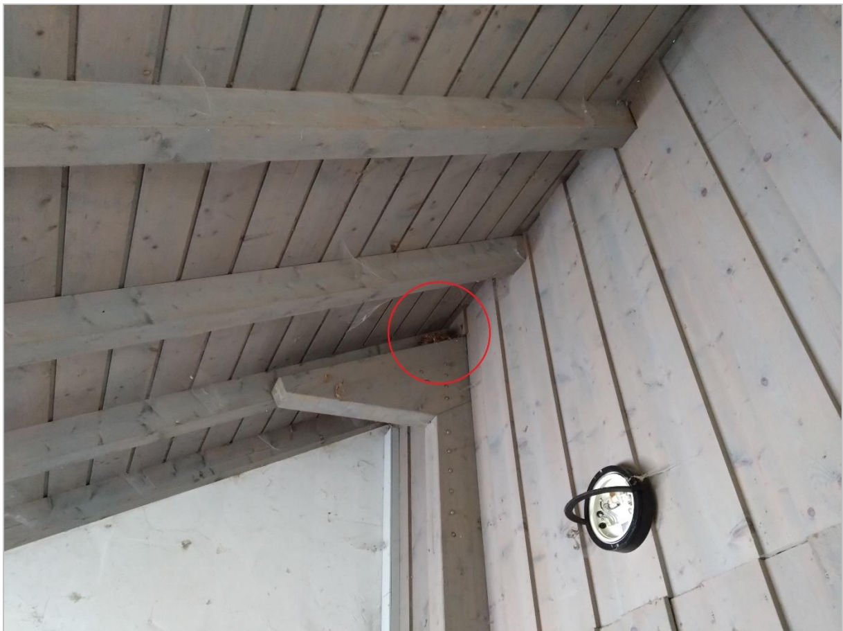
Abb. 8: Altes Vogelnest auf Nordseite der Turnhalle
